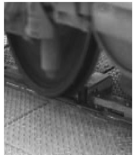
ARGUS, das automatische, im Gleis eingebaute Radsatz-Diagnosesystem
